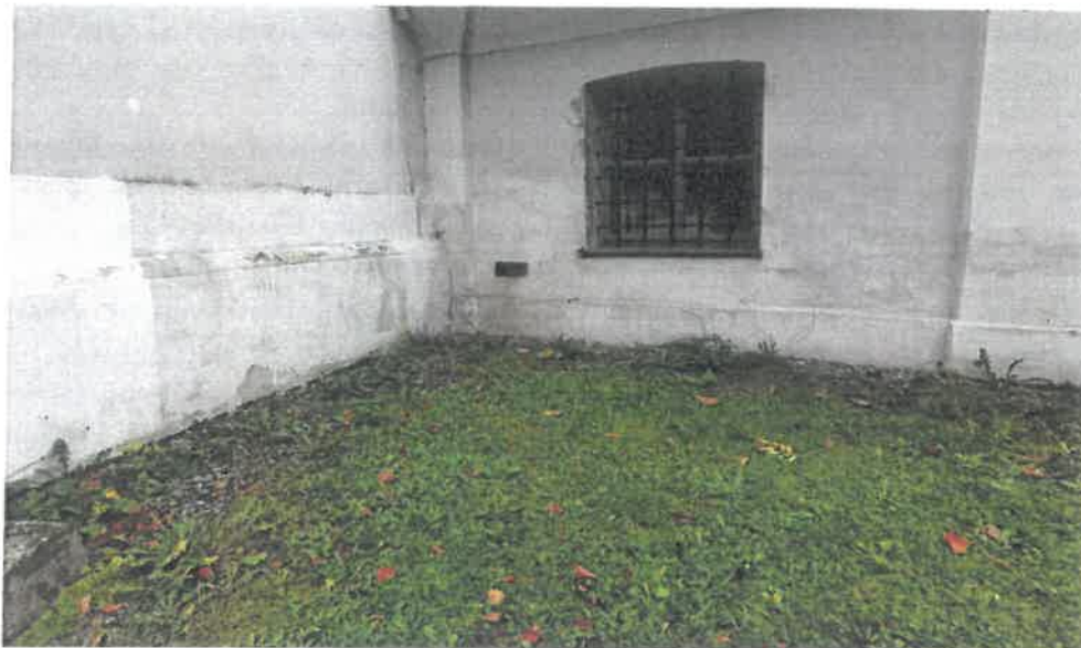
Fot. 7., 8. Stan zachowania. Widoczne zniszczenia w dolnej partii elewacji.
