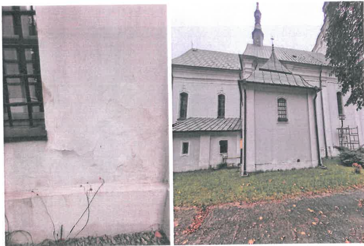
Fot 7. Stan zachowania – fragment, strefa przyziemia
