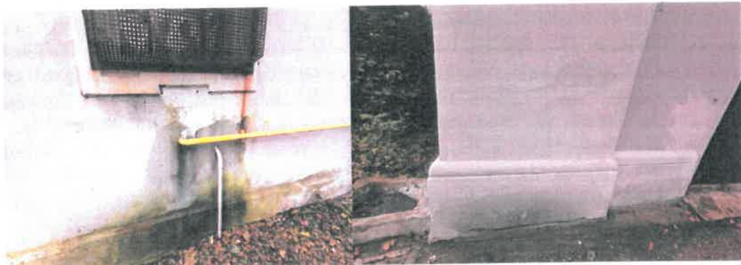
Fot. 3., 4. Stan zachowania. Widoczne zniszczenia spowodowane stałym zawilgoceniem partii elewacji
